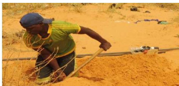
Figure 12 : un plombier en train d'installer un robinet pour un chantier de construction de maison
